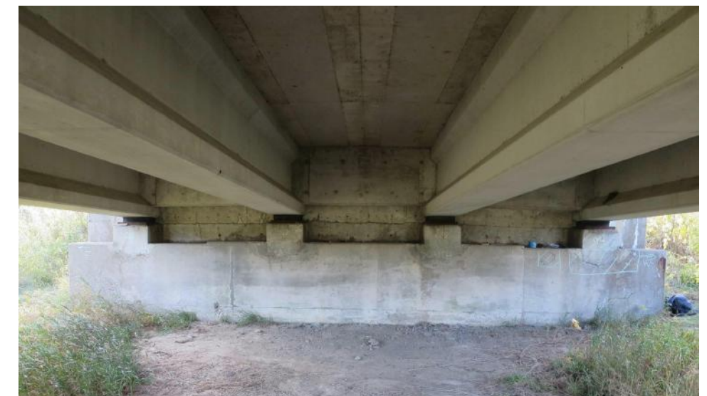
Les composants de la sous-structure sont en assez bon état et présentent des zones de détérioration et de fissuration.
