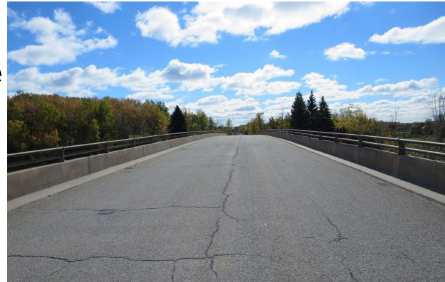
La surface d'usure de l'asphalte présente de larges fissures et du déchaussement partout.
