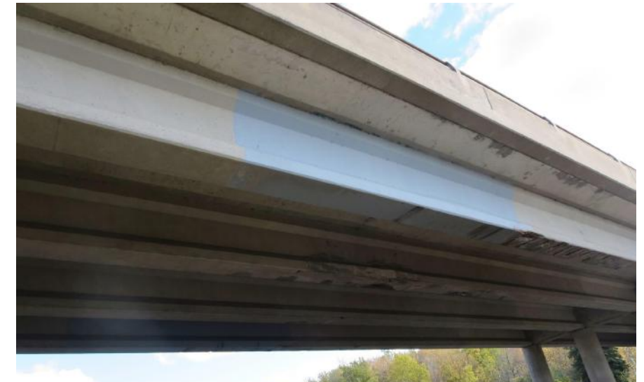
Le béton se détériore sur le dessous du pont et des poutres. Des collisions à charge élevée ont provoqué des dommages antérieurs au pont.
