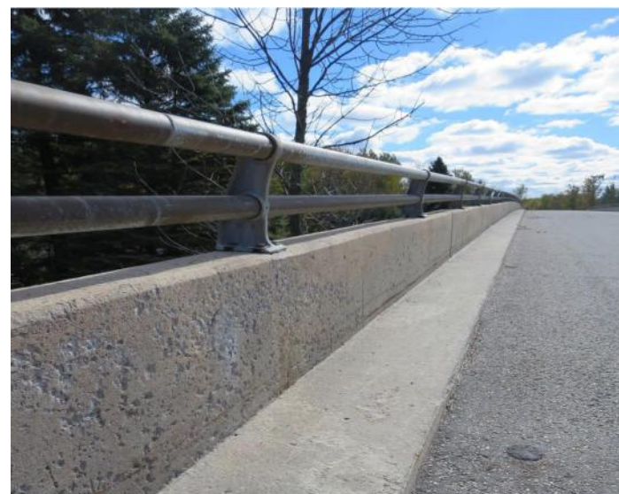
Le système de bordure et de parapet de pont ne respecte pas les normes de conception actuelles.
